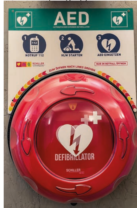
Automatischer Externer Defibrillator (AED) im Eingangsbereich der TVO-Halle
